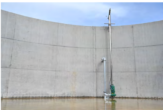
PRESSURA TP - Cuve en béton
