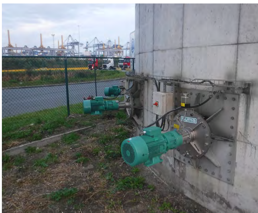
FR light - Cuve en béton
