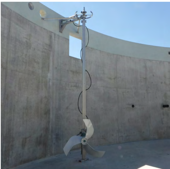
2G - Cuve fermée
