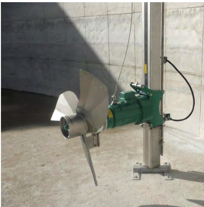
4G avec EV - Cuve fermée
