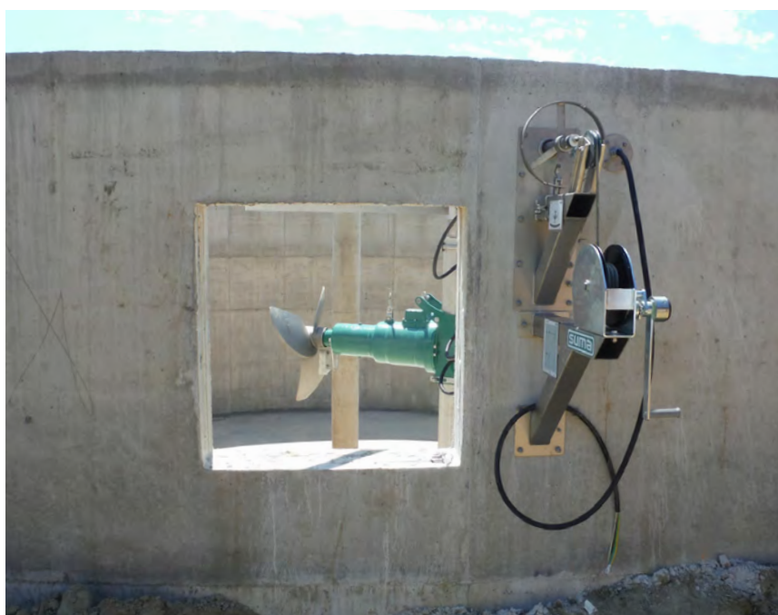
MGD - Cuve en béton avec 2G
