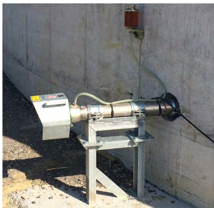
FR HY fixe - Cuve avec plafond en béton
